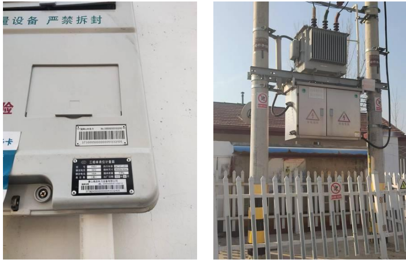
图 2-11 村庄电力设施现场照片
