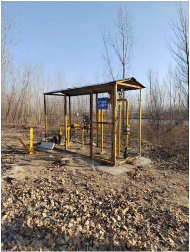
图 2-12 村庄燃气设施现场照片
