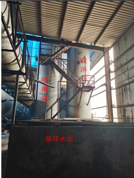
喷淋塔及循环水池
